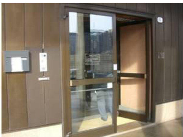
ACCESSO DA VIA VALERI 23 LOCALE CALDAIE
